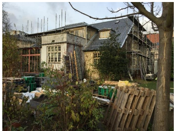
Krausesvej: Udskiftning af zinktag, renovering af skorsten, udskiftning af tagrender og nedløb
